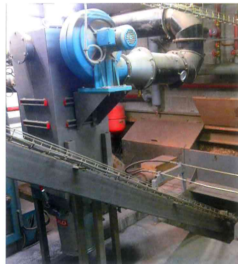
Automatische verbrandingsinstallatie waarmee het bedrijf verwarmd wordt met groene energie
